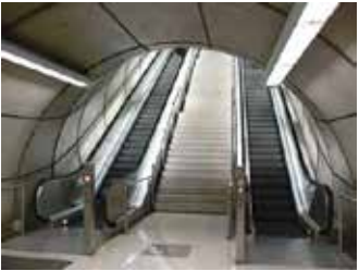
រូបភាព ១.២.៩.២. គំរូអំពីជណ្តើរយន្តដែល បង្ហាញពីទិសដៅឡើងចុះផ្សេងគ្នាមានបិទបញ្ជាឈប់ភ្លាមៗចាប់ភ្ជាប់នឹងមានជណ្តើរជើង នៅកណ្តាល
